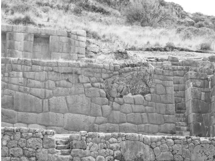
Tambomachay y su extraña corrosión
